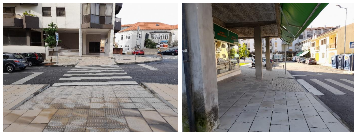
Figura 39. Exemplo de pavimento tátil mal executado (esq.) e rebaixamento mal executado (dir.) associados a atravessamentos pedonais
