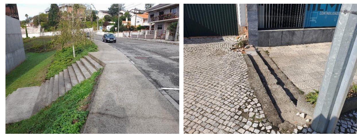
Figura 28. Exemplos de escadas (não regulamentares) (esq.) e degrau (dir.) a obstruir o percurso pedonal na área de estudo
