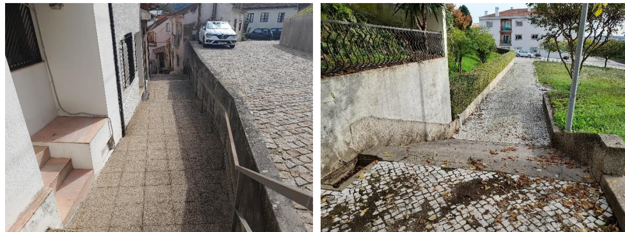
Figura 22. Exemplos de corrimão com execução indevida (esq.) e ausência de corrimãos (dir.). Fonte: mpt®, 2021
