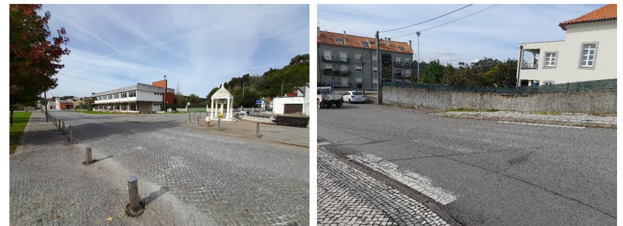
Figura 29. Exemplos de ausência (esquerda) e pintura degradada (direita) das passadeiras Fonte: mpt®, 2021
