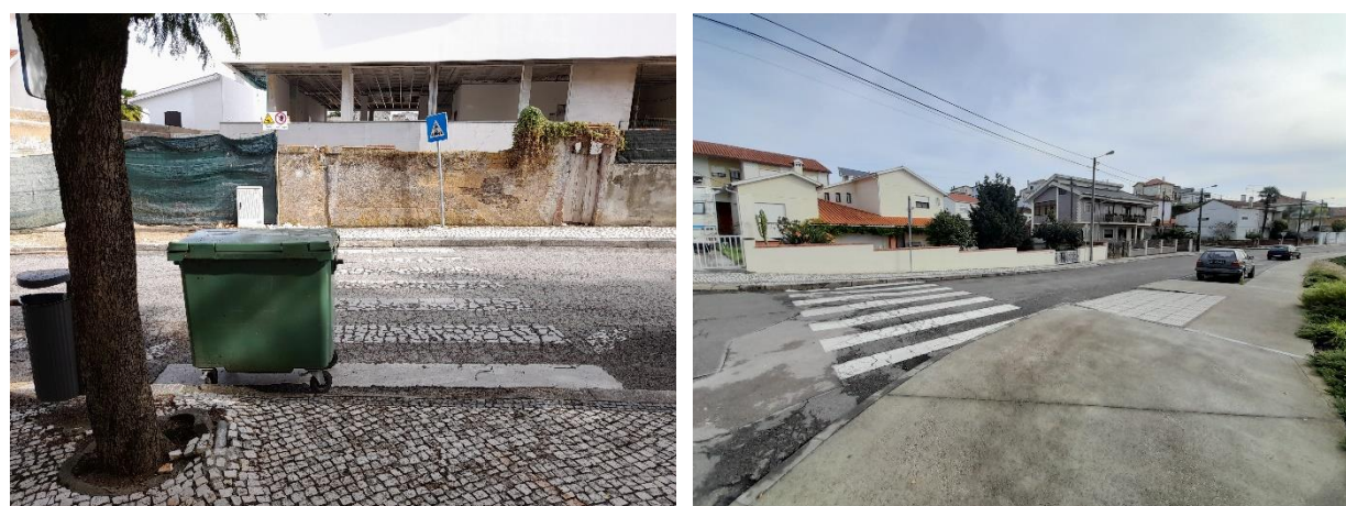
Figura 33. Exemplos de passadeira com pavimento degradado Fonte: mpt®, 2021
