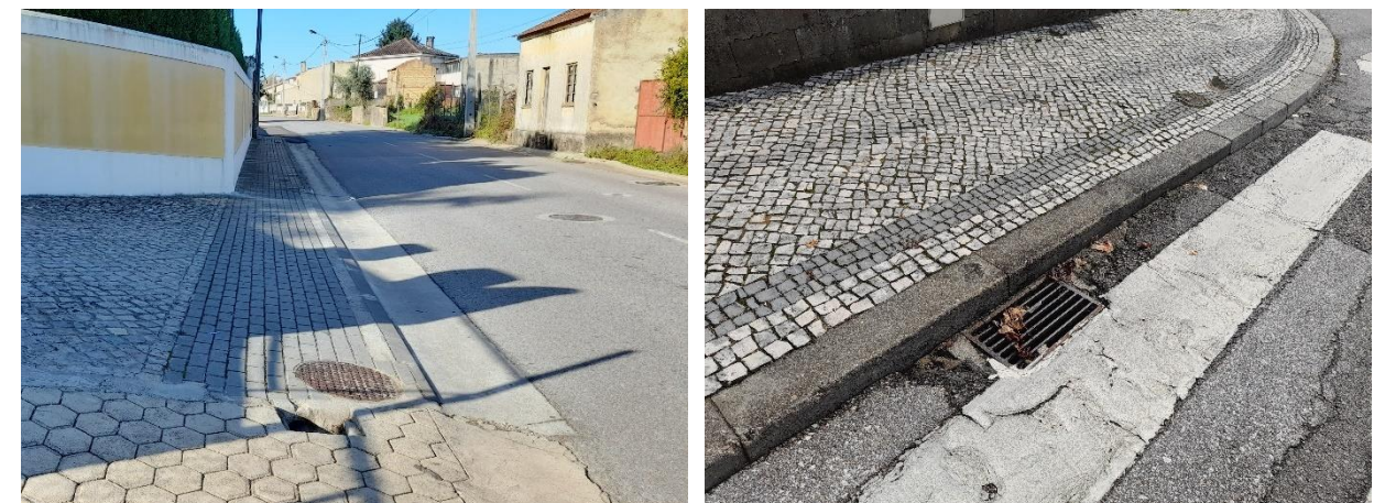
Figura 26. Exemplos de buraco (esq.) e grelhas (dir.) a obstruir o percurso pedonal Fonte: mpt®, 2021
