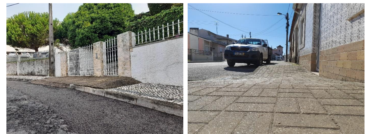
Figura 39. Exemplos de rampa a obstruir o percurso pedonal Fonte: mpt®, 2021
