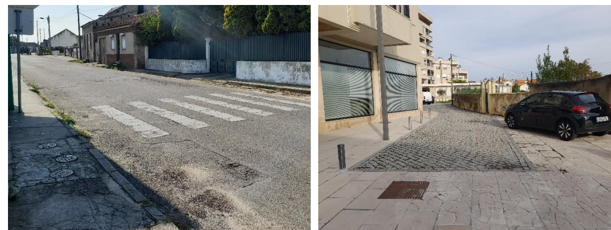
Figura 34. Exemplos de pavimento degradado Fonte: mpt®, 2021
